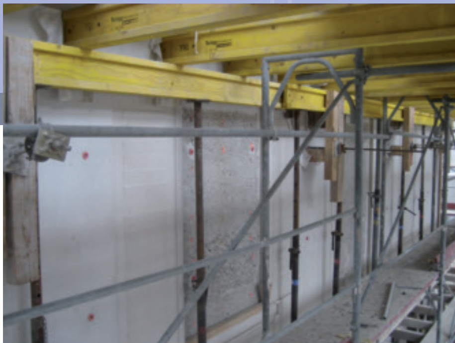
Um beim Ausschalen Probleme zu vermeiden, werden die vertieften Fensteröffnungen in einer extra Etappe betoniert.
