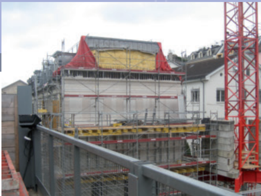
Das teilweise abgebrochene Gebäude erhielt eine neue Südfassade mit der nachgezeichneten, jedoch invertierten, alten Struktur im weiss pigmentierten Beton.
